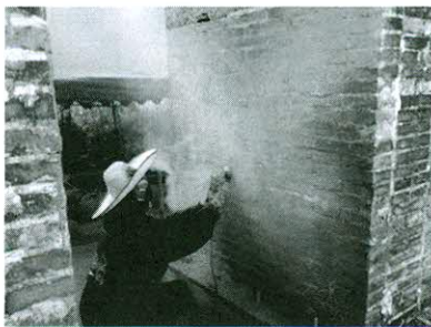
รูปที่ 8 ขัดพื้นผิวผนังอิฐก่อตัวอย่างเพื่อติด FRP
