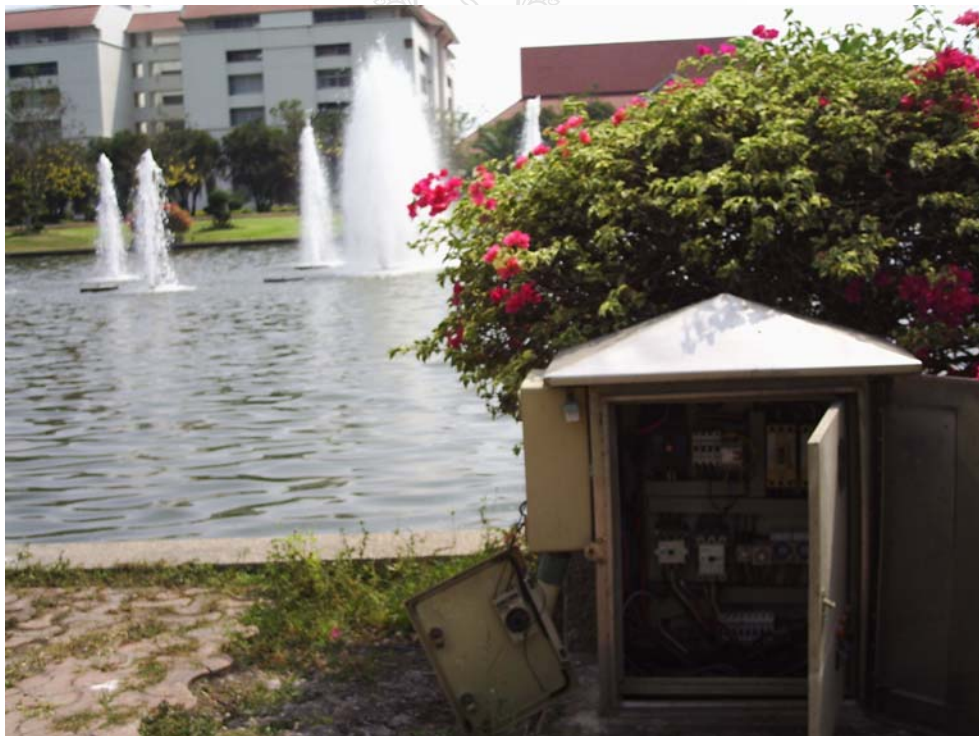
รูปที่ 3.2 ตู้ควบคุมระบบไฟฟ้าของสระน้ำพุ รับกระแสไฟฟ้าจากเสาไฟถนน
