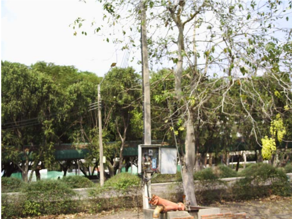
รูปที่ 3.1 เสาไฟถนน ที่จ่ายกระแสไฟฟ้า ให้กับตู้ควบคุมระบบไฟฟ้า ของสระน้ำพุ
