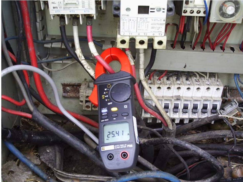
รูปที่ 3.3 ขณะวัดกระแสไฟฟ้า ภายในตู้ควบคุมระบบไฟฟ้าของปั้มน้ำพุ
