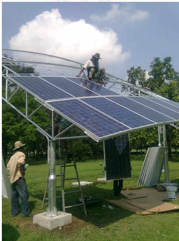
รูปที่ 3.18 ด้านหน้าของการติดตั้งแผงเซลล์แสงอาทิตย์
