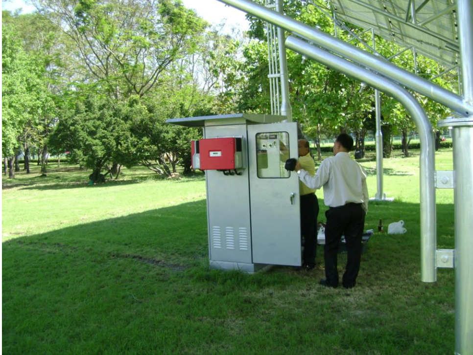
รูปที่ 4.3 การทดสอบระบบ บหลังการติดตั้งระบบไฟฟ้าแล้วเสร็จ
