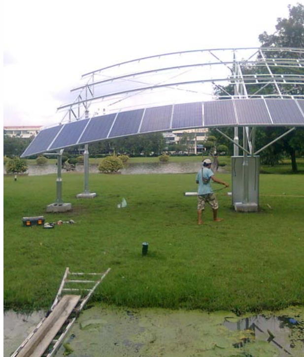
รูปที่ 3.16 การติดตั้งแผงเซลล์แสงอาทิตย์ บนโครงสร้างรองรับแผงเซลล์แสงอาทิตย์
