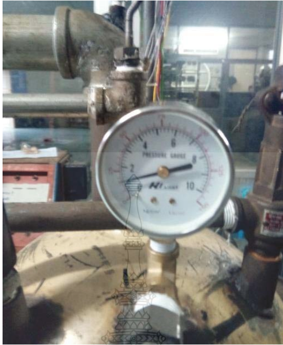
รูปที่ ข. 15 Pressure gauge ขณะจ่ายไอน้ำเข้าห้องเผาไหม้
