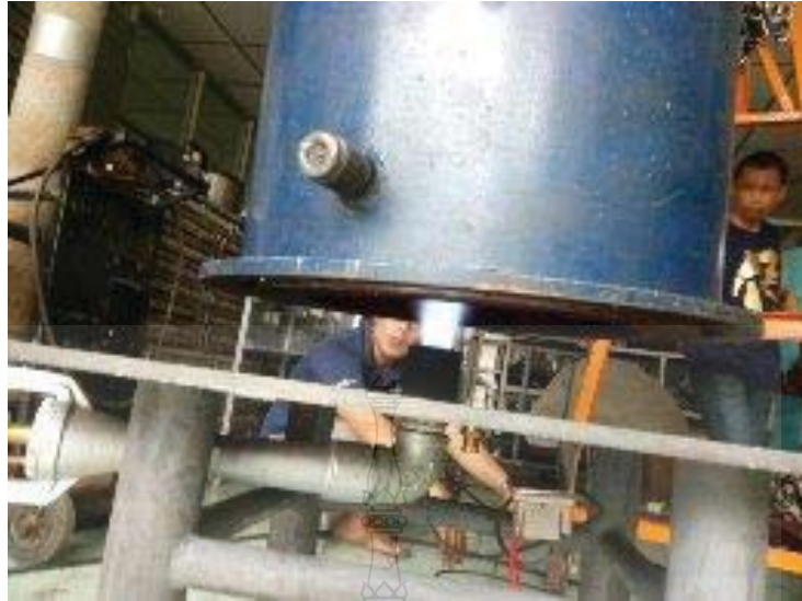
รูปที่ ข.7 ติดตั้งและทดสอบจุดเตาเผาของหม้อไอน้ำ
