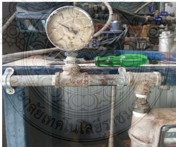
รูปที่ ข. 16 Pressure gauge ของท่อแก๊สหุงต้ม
