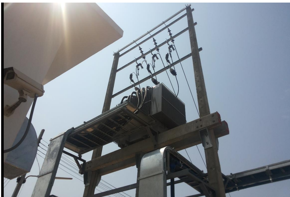
รูปที่ 3.8 หม้อแปลงไฟฟ้ากำลัง ขนาด 1250 kVA 22kV-300V 50Hz Dd0y11 Z = 6%
