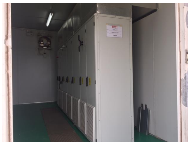
รูปที่ 3.13 อินเวอร์เตอร์ ABB รุ่น PVS800-57-1000kW-C
