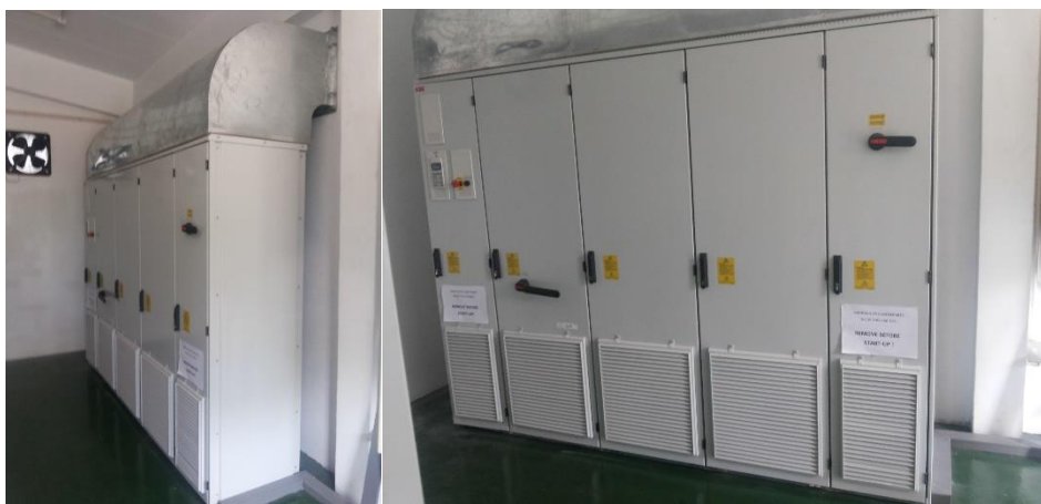
รูปที่ 3.6 อินเวอร์เตอร์ ABB รุ่น PVS800-57-0500kW-A
