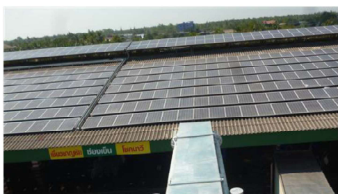
รูปที่ 2 โรงไฟฟ้าพลังงานแสงอาทิตย์ แบบติดตั้งบนหลังคา
