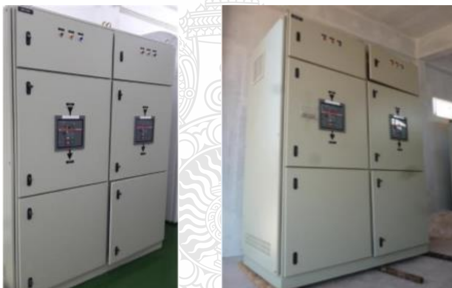
รูปที่ 3.7 ตู้ควบคุมไฟฟ้าหลัก MDB. (Main Distribution Board) ตั้งอยู่ภายในห้องควบคุมไฟฟ้า
