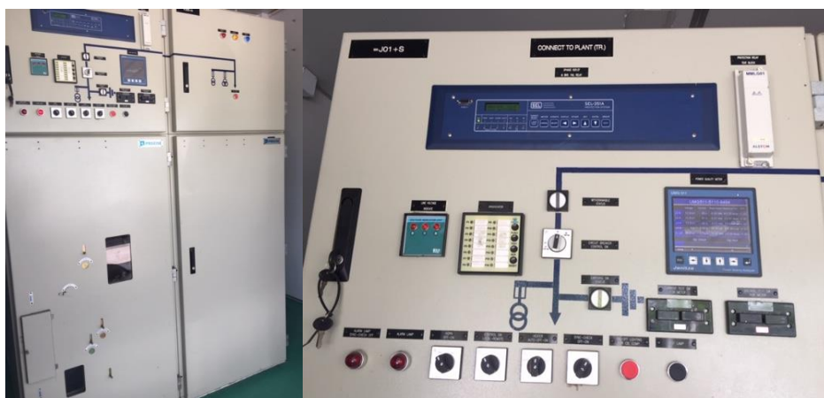
รูปที่ 3.15 สวิตช์เกียร์(Switch Gear)
