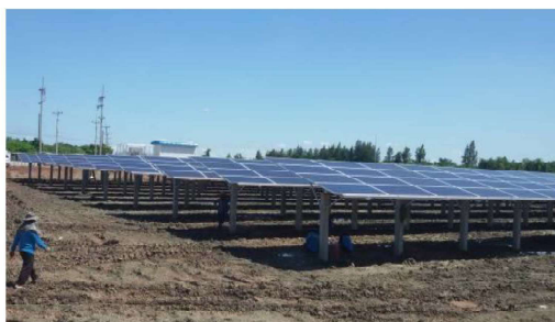
รูปที่ 3 โรงไฟฟ้าพลังงานแสงอาทิตย์ แบบติดตั้งบนพื้นดิน
