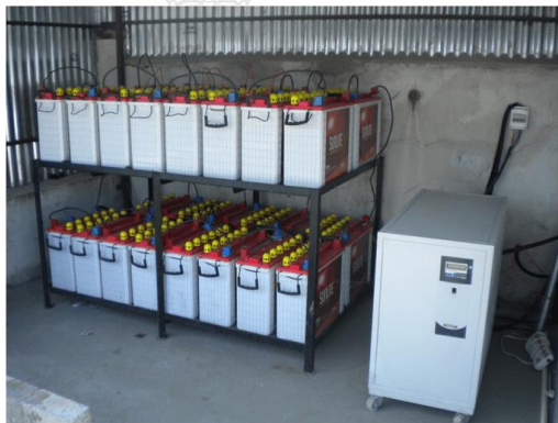
รูปที่ 2.19 แบตเตอรี่ไฟสำรองรวม (Battery Pack) [24]
