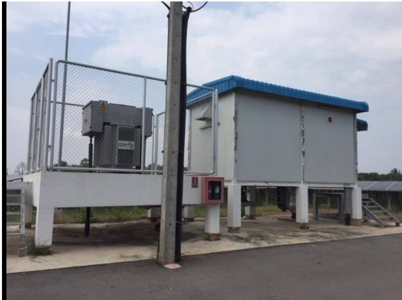
รูปที่ 3.14 หม้อแปลงไฟฟ้ากำลัง ขนาด 1250 KVA 22kV-315V 50Hz Dd0y11 Z = 6\%
