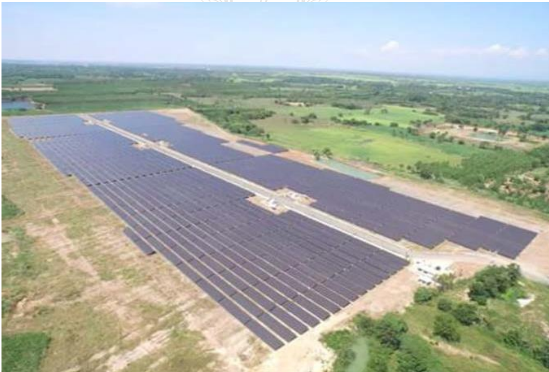
รูปที่ 3.2 โรงไฟฟ้าพลังงานแสงอาทิตย์ ชนิดฟิล์มบาง
