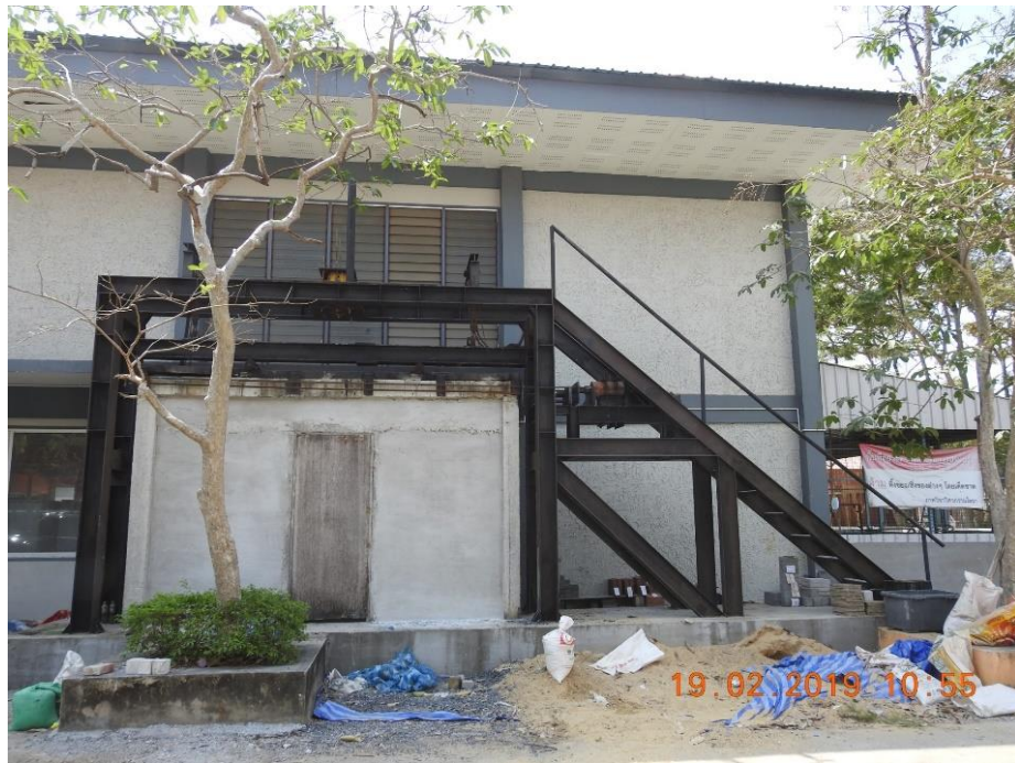
รูปที่ 3.9 โครงเหล็กสำหรับติดตั้งอุปกรณ์ทำการทดสอบ
