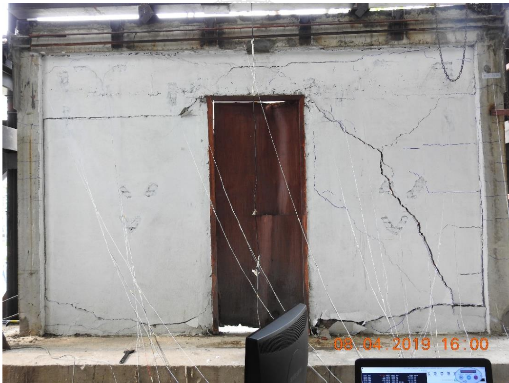
รูปที่ 4.1 ผนังอิฐก่อตัวอย่างภายหลังการทดสอบ W
