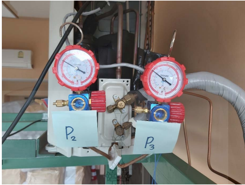
รูปที่ ก.13 เครื่องวัดความดันสารทำความเย็น(Pressure gauge)
