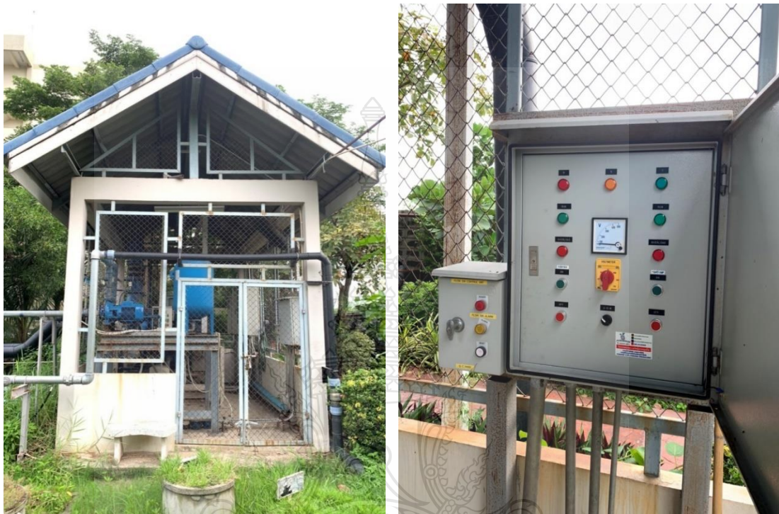
ภาพที่ 4.21 (ซ้าย) ห้องปั้มน้ำหน้าโรงเฟิร์นภูมิทัศน์ (ขวา) ตู้ควบคุมไฟฟ้าระบบปั้มน้ำ
