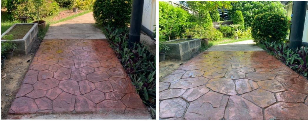
ภาพที่ 4.37 ผลงานการก่อสร้างพื้นผิวคอนกรีตพิมพ์ลายที่เสร็จสมบูรณ์
