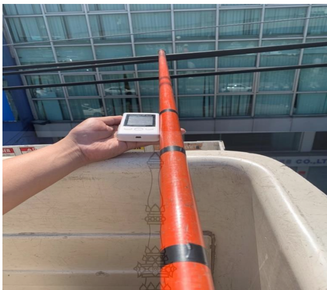
รูปที่ 4.15 การวัดค่าสนามไฟฟ้าและสนามแม่เหล็กในระบบไฟฟ้าชิงอากาศ พิกัดแรงดัน 24 kV ร่วมกับพิกัดแรงดัน 69 kV ที่ระยะ 1.40 เมตร
