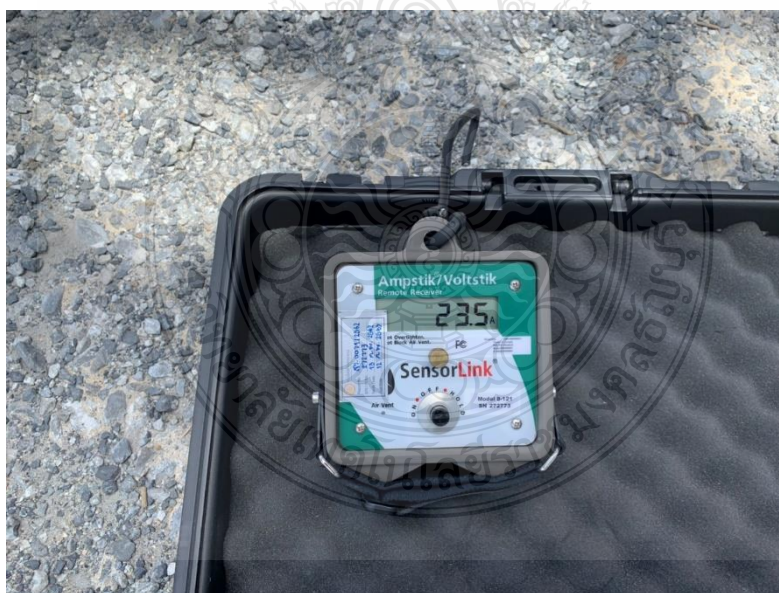
รูปที่ 4.14 การวัดค่ากระแสไฟฟ้าระบบไฟฟ้าชิงอากาศ พิกัดแรงดัน 24 kV
