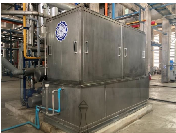
รูปที่ 3.23 ระบบทำน้ำเย็นชนิด Ripple plate กำลังการผลิต 60 ลูกบาศก์เมตรต่อชั่วโมง
